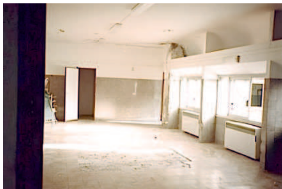
Fig. 17 Condizioni dei locali della scuola materna prima degli interventi (1994): ambienti umidi, arredi danneggiati e spazi inadatti che ne hanno reso urgente il restauro
