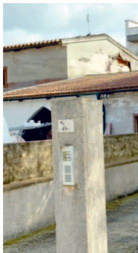
Fig. 17 Una delle cosiddette case "svedesi" realizzate negli anni Ottanta. La parete laterale appare sventrata, con segni evidenti di usura e cedimenti strutturali
